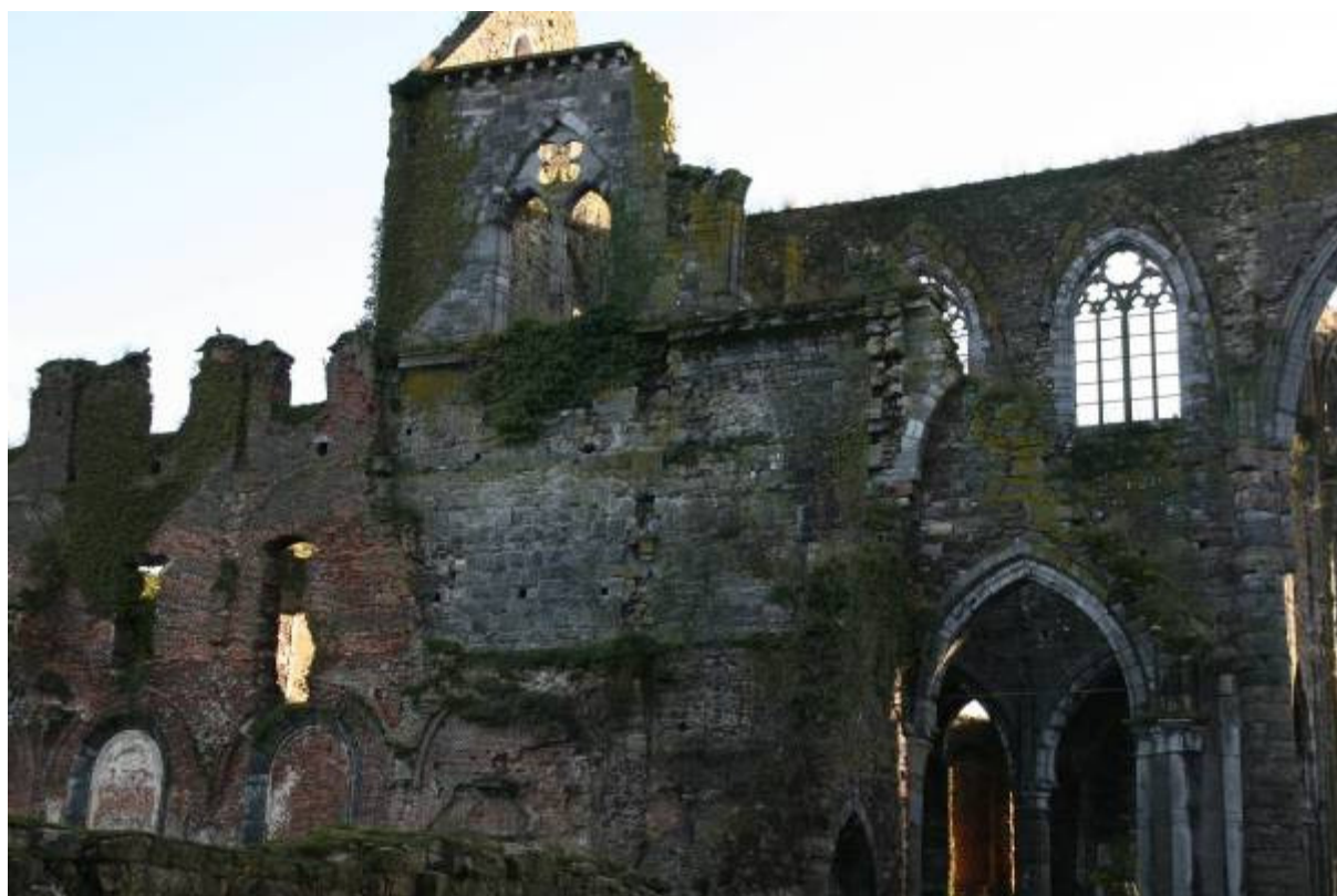
Fig. 2 : Eglise abbatiale d'Aulne (Thuin). Fissures dans la maçonnerie [Photo : M.D.].
