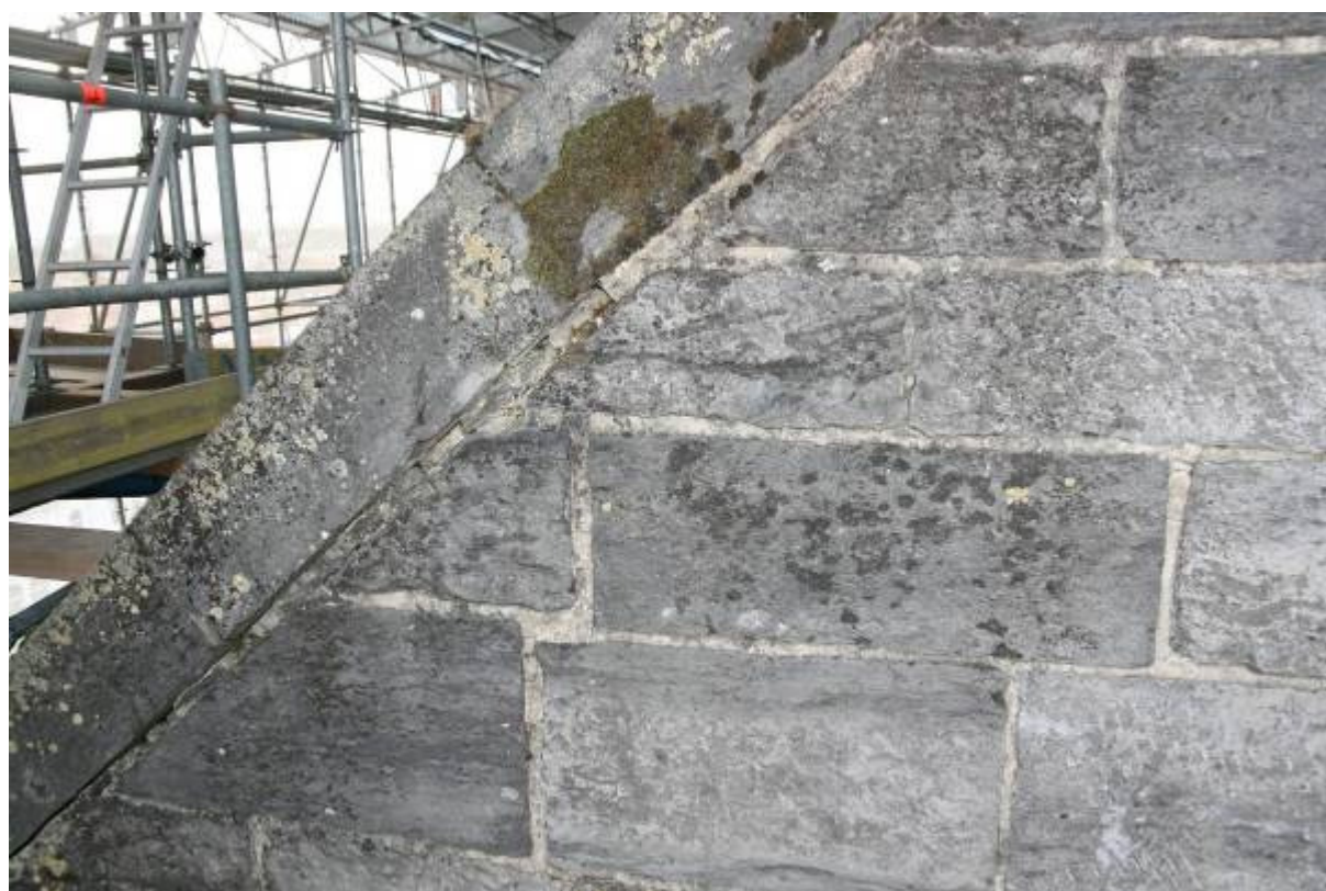
Fig. 3 : Façade occidentale de la Cathédrale Notre-Dame à Tournai. Décollement des joints [Photo : M.D.].
